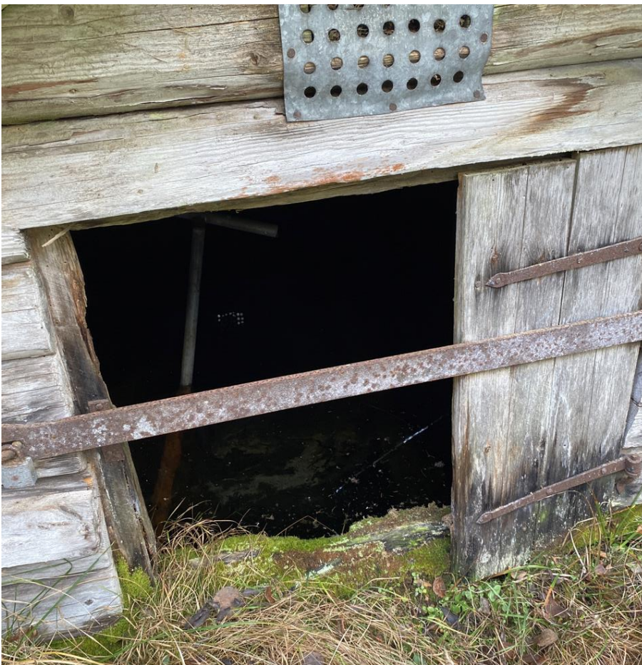
Figur 10. Vattenfylld mindre hus med reglage. Sannolikt från tidigare jordbruksverksamhet.
